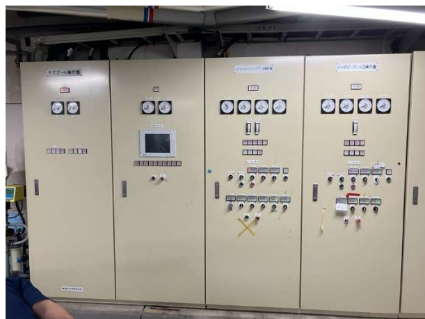
【サブプール動力操作盤】
